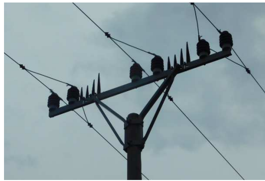
x - poškozené nebo nefunkční
