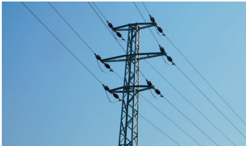
ZV - sloup „železný velký“ = příhradový sloup v dvojlince
