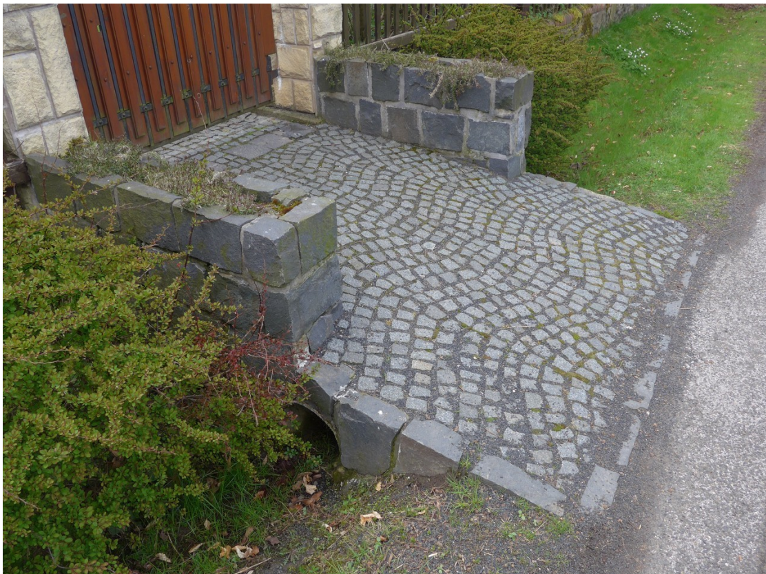
Vchod do domu s trubkou
